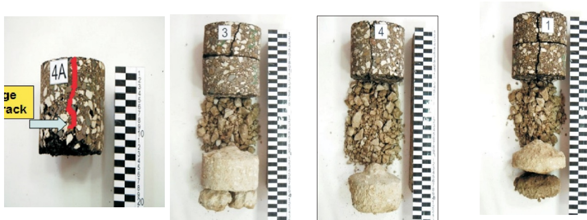
Рис. 2. Фотографії кернів з тріщин біля основи між технологічними швами
